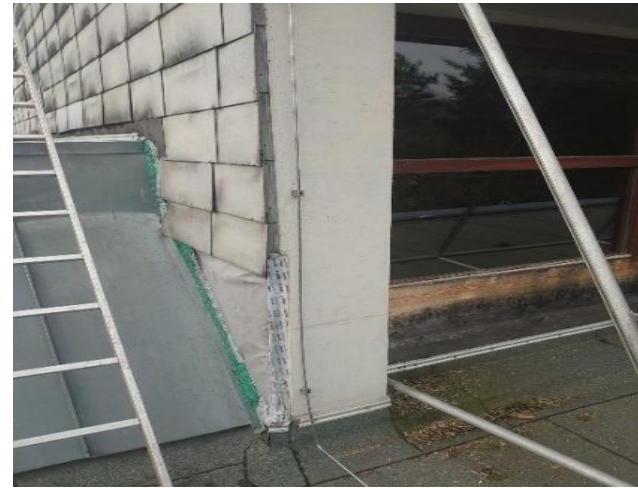
Provisorisch geflickte Wandanschlüsse
