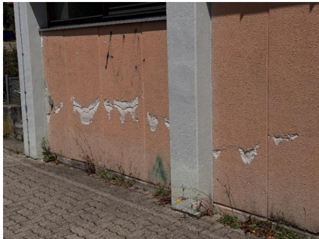
Mürbe, absandende Wandelemente
