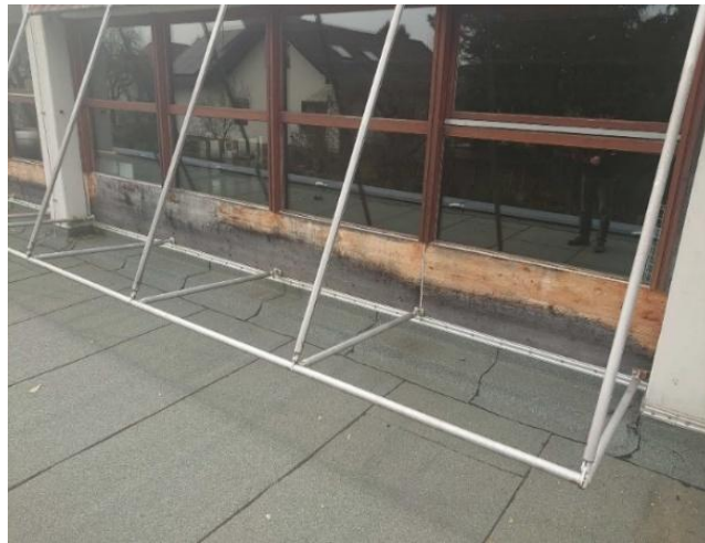
Stark verwitterte, mürbe Fensterhölzer
