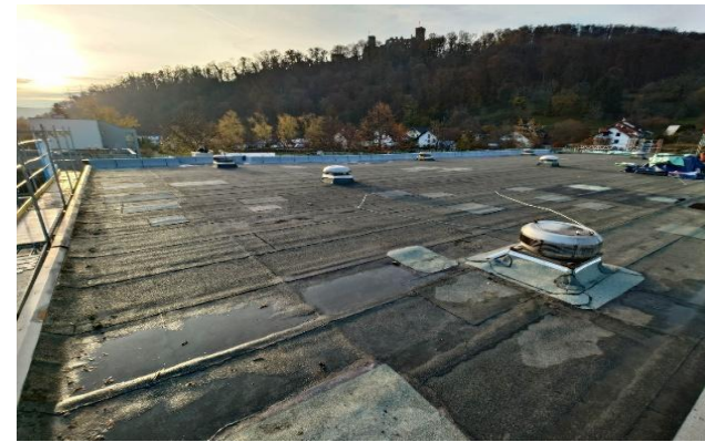
Mehrfach geflickte Dachflächen
