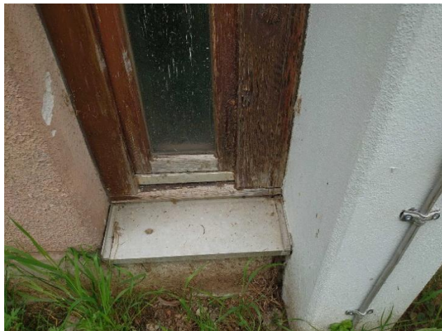
Sanierungsbedürftige Stahlbetonbauteile sowie stark verwitterte und mürbe Holzfensterprofile
