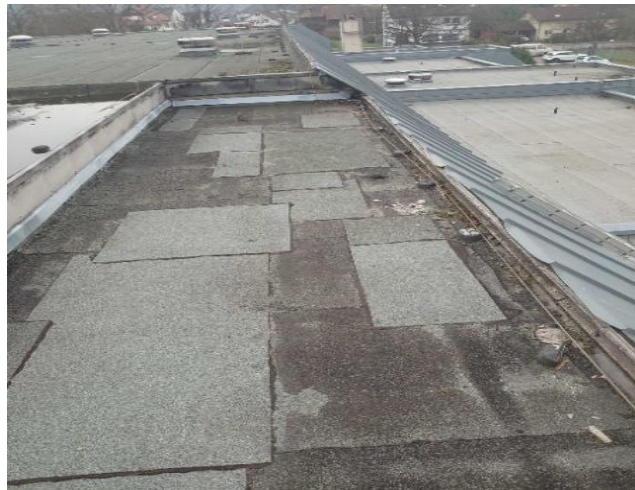
Mehrfach geflickte Dachflächen
