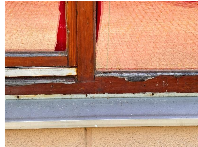
Stark verwitterte, mürbe Fensterhölzer
