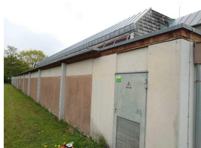
Wandsystem durch Bodenfeuchte zersetzt
