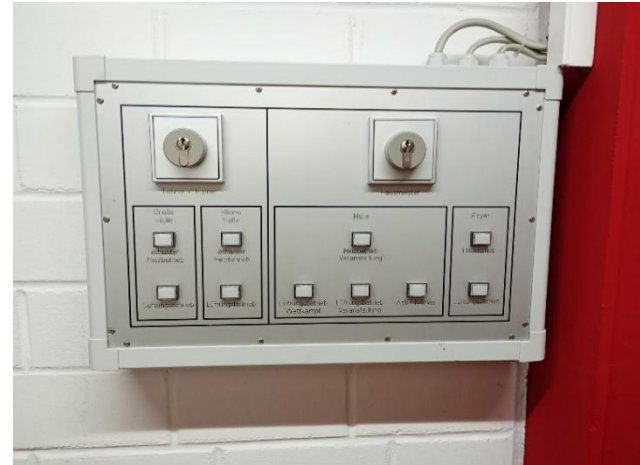
Veraltete Heizungssteuerung für die Halle
