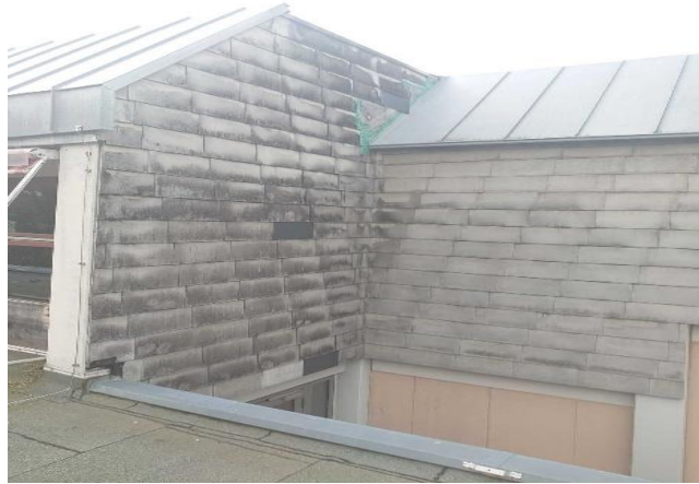
Fassadenbekleidung mit Fehlstellen und provisorischer seitlicher Anschlüsse
