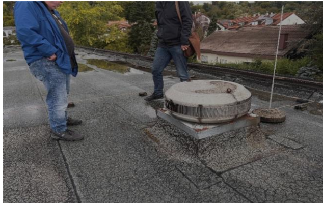
Blasenbildung unter Bitumendach
